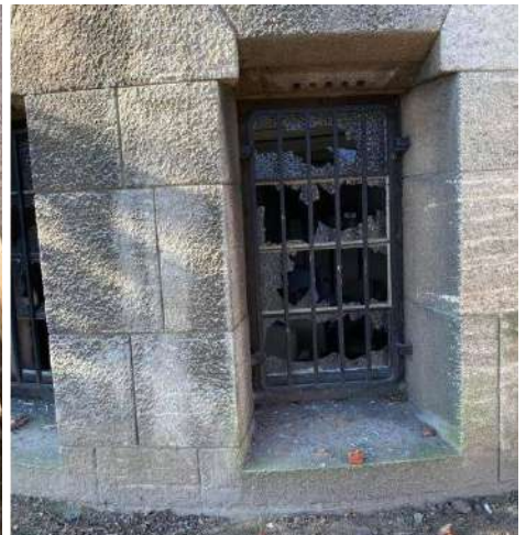
Vandalisme aan de basiliek van Koekelberg a.d.h.v. straatstenen.
